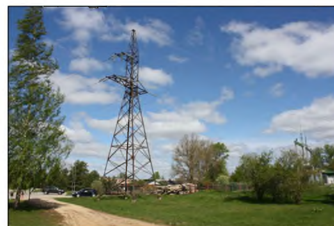
123 Augstsprieguma līnijas balsts
