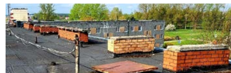
Ventilācijas izvadi ēkā Mežrūpnieku ielā 8 pirms remonta
